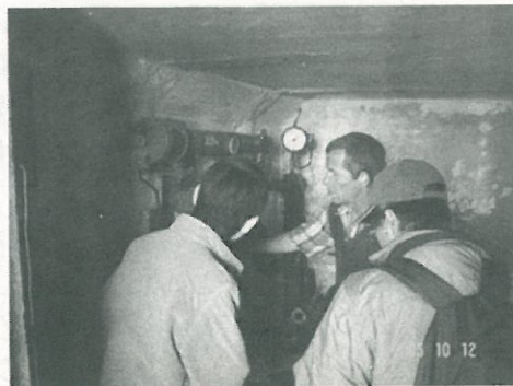
〈故障しているポンプの説明を受ける訪問団〉
